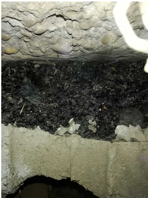
Bethlen G u. 6. szám sarki ingatlanánál lévő ülepítő fordító akna áteresztő bekötése a Kölcsey utca útburkolat alatti átvezetése irányában, erősen eltömődve
